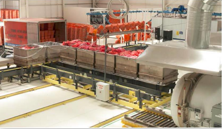
Tıbbi Atık Sterilizasyon Tesisi Tesis Kapasitesi: 108 ton/gün (145 °C-3,2 bar)
